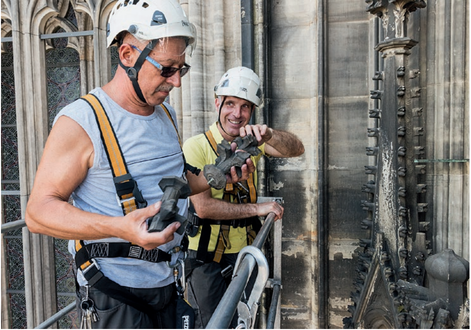
10. Abnahme von gelösten Kreuzblumen bei der Befahrung des Südturmes.
