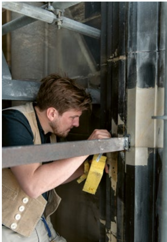
2 | Setzen von Vierungen in den Fenster- gewänden des Westfensters im Glocken- stuhl
