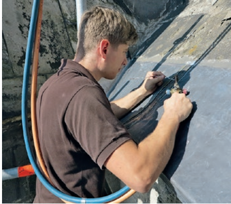
20. Abdeckung des schadhafte Wasserschlaes über der Gedenkplatte der Dombaufeyer von 1845
