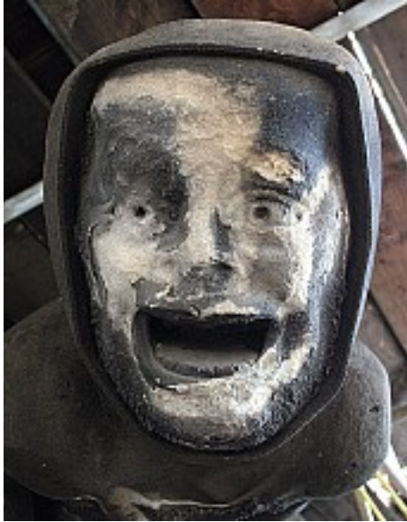
11. Wasserspeier von Pfeiler H 8 mit Verwitterungsschäden.
