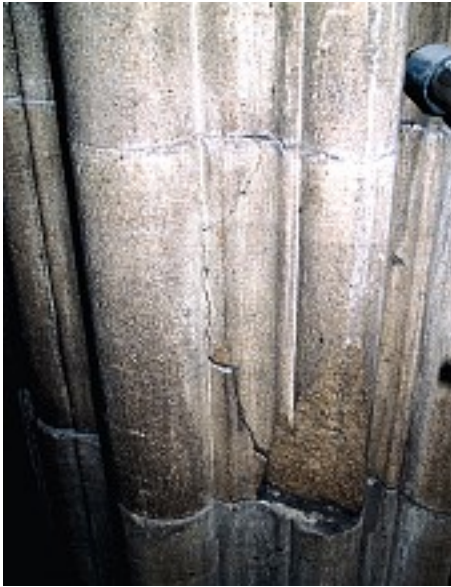
7. Schäden im westlichen Gewände des Südquerhausfensters.
