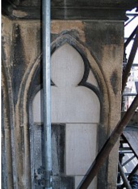
2. Zurückhaltend ergänzte Partien im mittleren Bereich des Strebepfeilers F 6 an der Langhausnordseite.
